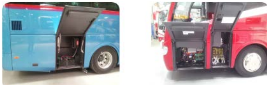
Localització habitual de les bateries
