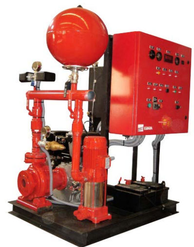
Abastament d'aigua contra incendis amb un sistema de bombeig únic. Font: enginyersbcn.cat
